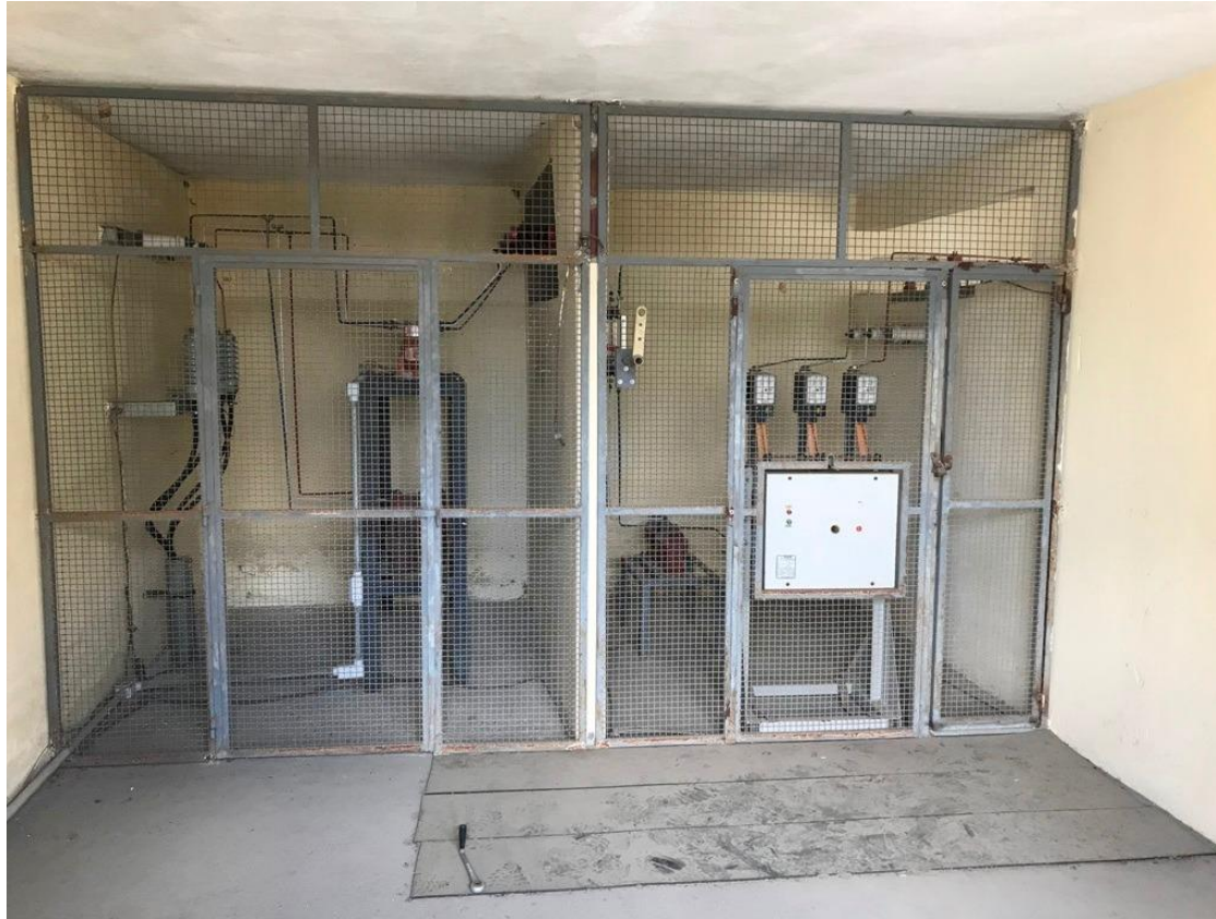
Cabine Medição e Proteção
