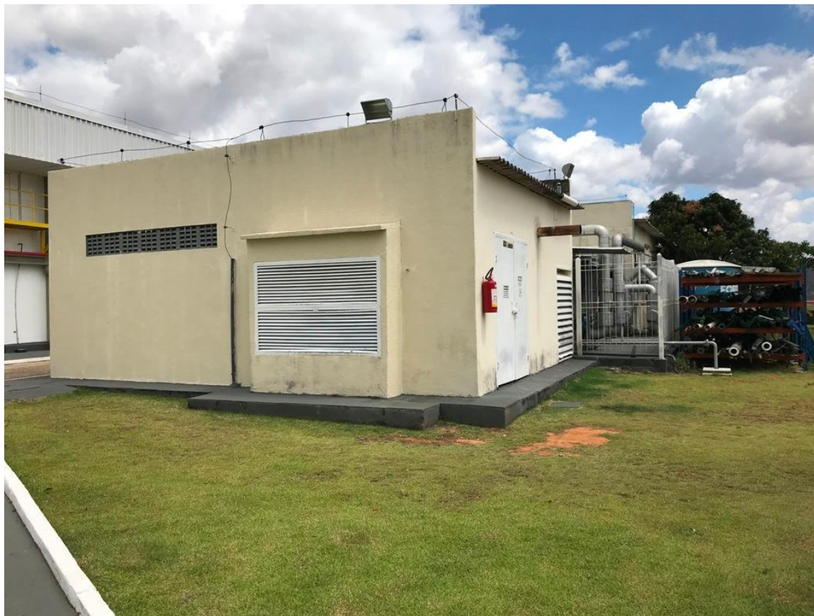
Cabine do transformador 750 kVA a seco e quadros distribuição
