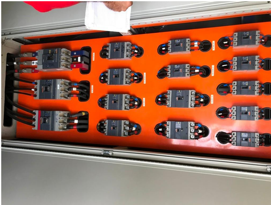
Quadro de distribuição
